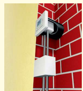
Regelgerät montiert in Schalterdose Abzweigkasten beim Anschluss mehrerer Heizmatten
